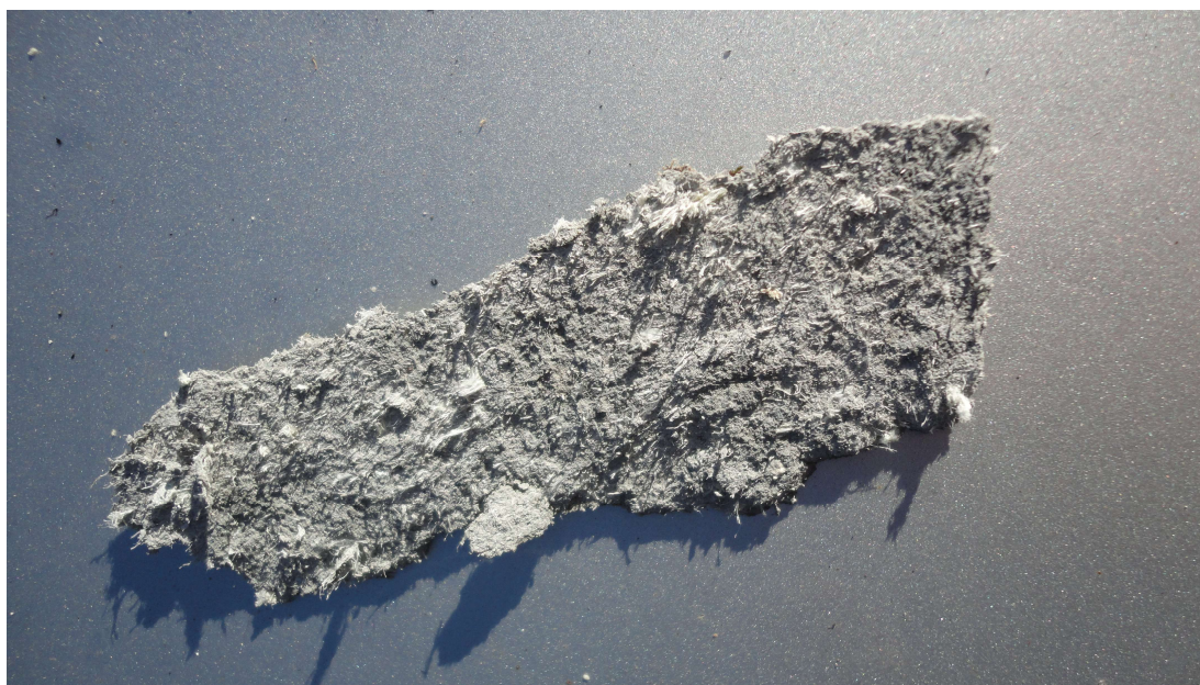
Stykke af en eternittagplade, der er sprængt af ved brand. Asbestfibre ses som samlinger af hvide fibre.
