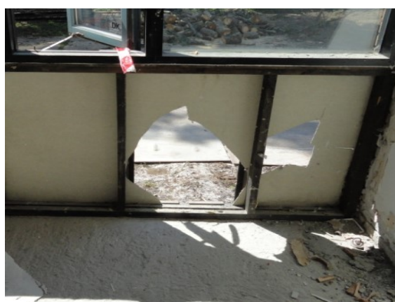
Vægplader med asbest
