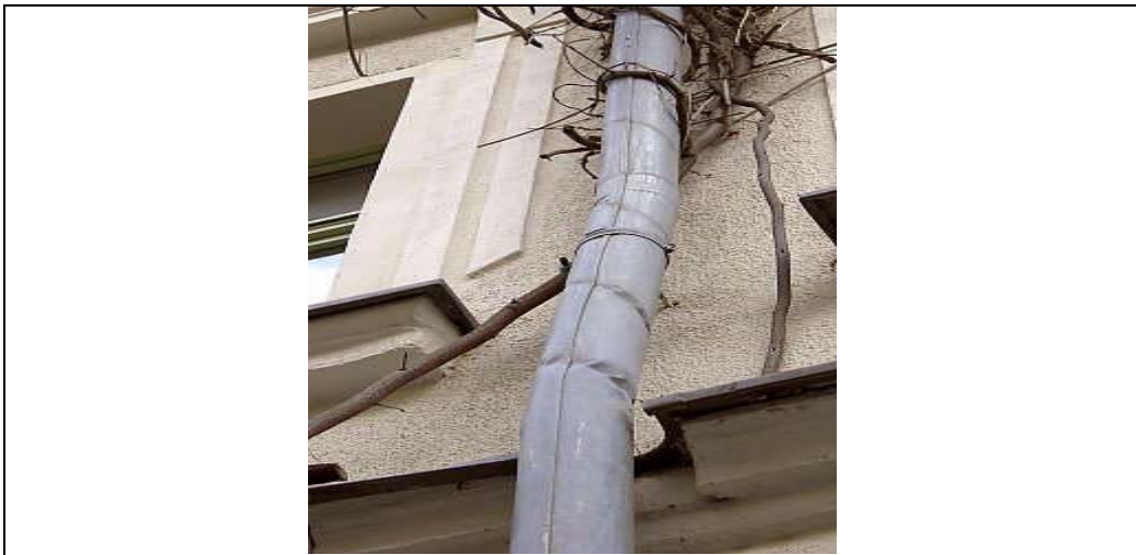
Figur 2.2 Nedløbsrør deformeret af blåregn ( Wisteria )
