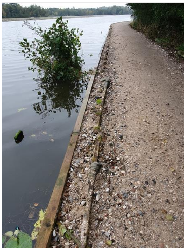
Figur 5: Foto af den renoverede brinksikring. Den nye brinksikring er sat ca. 20 cm uden for den gamle brinksikring og mellemrummet er fyldt op med grus. Foto er taget ved besigtigelse af strækningen den 28. oktober 2020.
